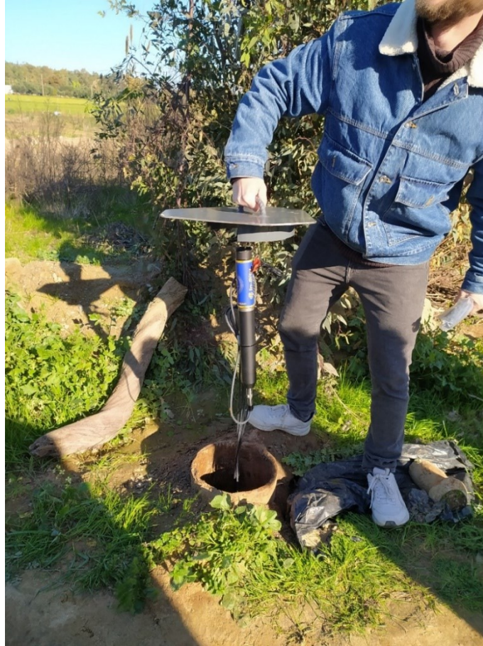
Φωτό 3: Εγκατάσταση συστήματος υδρογεωλογικών παραμέτρων στον σταθμό ΤΕ-2 (Αραξος)
